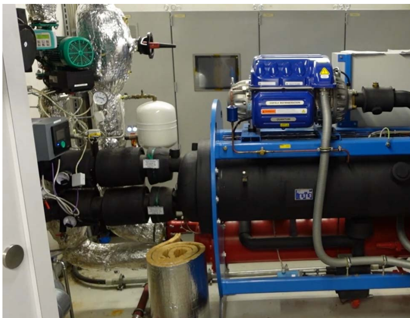
Das Kernstück der Wärmepumpe vom E.ON ERC (250 kW), eingebunden in eine optimierte Betriebsführung
